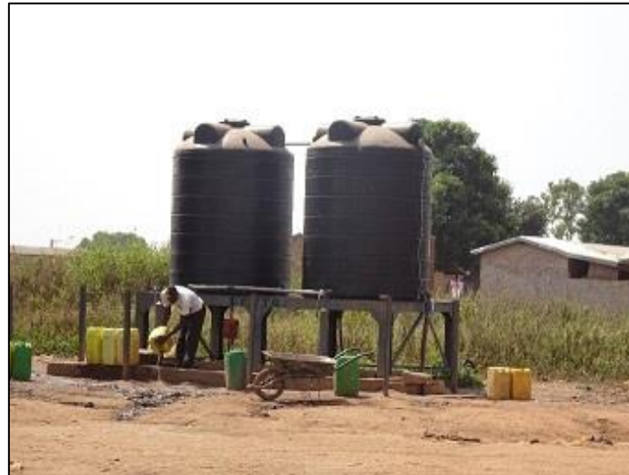
Figure 20-3 Réservoirs d'eau à Fadiadougou
